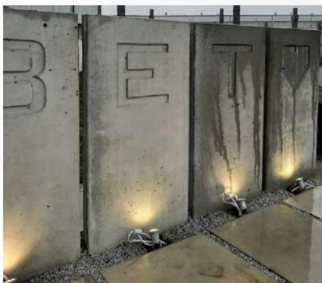
Abb. 6. Links: Mauern mit LOVBET Imprägnierung, rechts: ohne Imprägnierung
